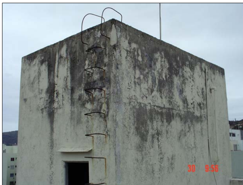
Figura 65 - Manchas escuras provenientes de micro-organismos fixados à pintura
