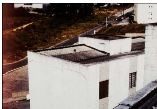
Figura 10 - Típica trinca no topo da parede e destacamento da platibanda por movimentações térmicas da laje (THOMAZ, 1992).
