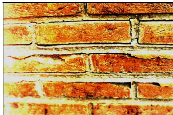
Figura 24 - Expansão da argamassa de assentamento decorrente da presença de sulfatos (THOMAZ, 1992).
