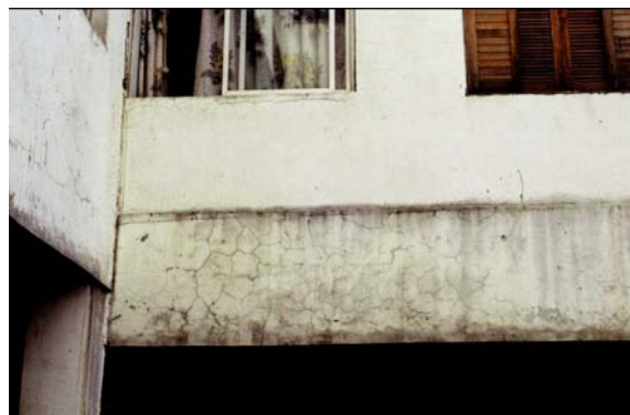
Figura 22 - Fissuras de retração em concreto armado, causadas pela elevadíssima quantidade de cimento e/ou relação água-cimento do concreto (THOMAZ, 1992)
