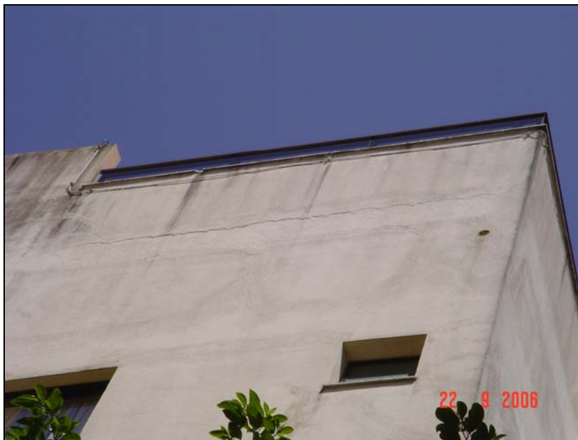
Figura 83 - Fissura horizontal na interface da platibanda com a laje de cobertura
