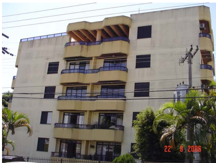
Figura 77 - Aspecto da fachada sudoeste totalmente manchada
