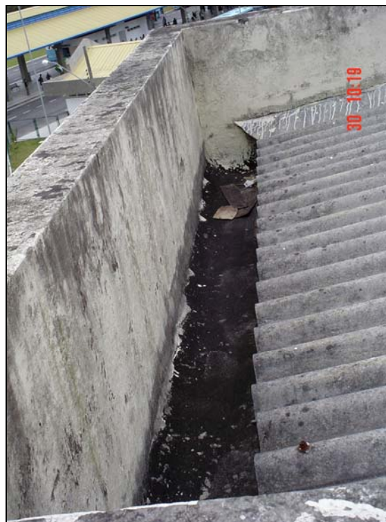
Figura 64 - Calha com impermeabilização em avançado estado de deterioração junto a platibanda com o RAF danificado.
