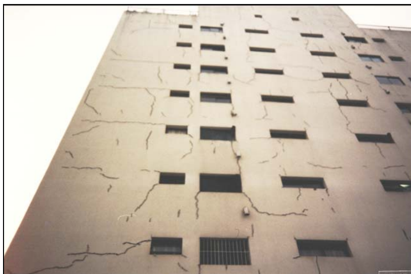
Figura 6 - Fissuras nos cantos das janelas decorrentes da inexistência de vergas e/ou ontra-vergas (THOMAZ, 1992)
