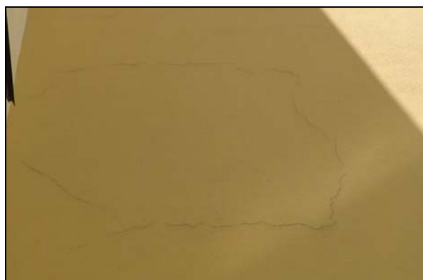
Figura 81 – Detalhe da fissura.
