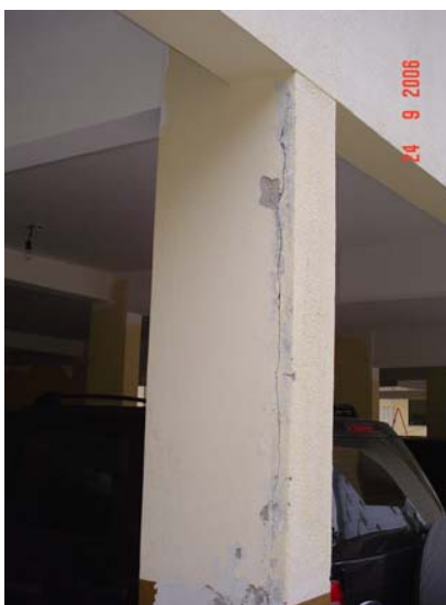
Figura 79 - Fissura vertical junto ao pilar situado na fachada Oeste.
