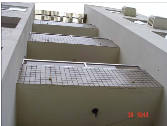
Figura 53 - Registra o posicionamento das demais rachaduras, todas localizadas no alinhamento das saídas pluviais.
