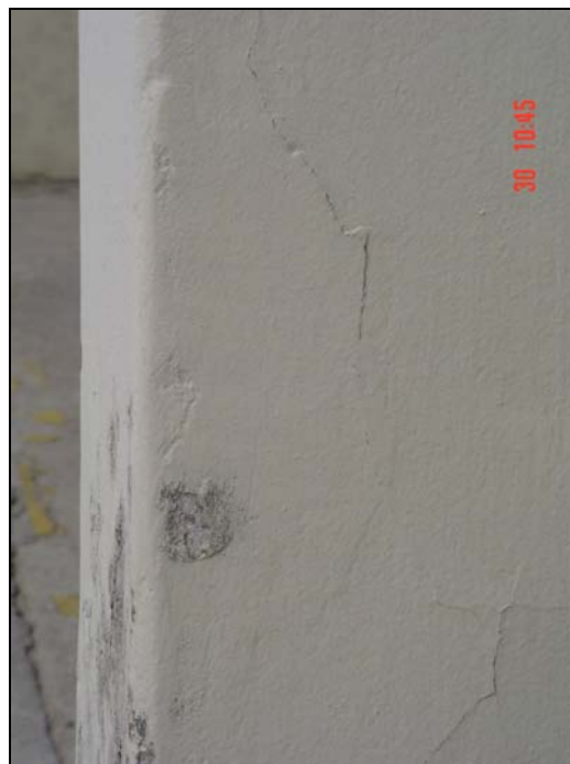
Figura 45 - Detalhe das fissuras
