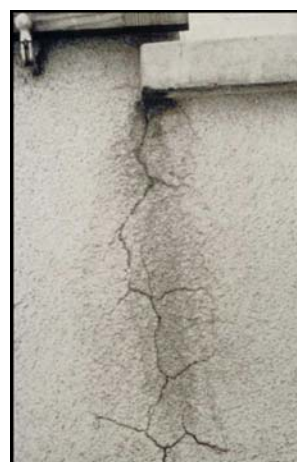
Figura 12 - O fluxo de água interceptado do peitoril da janela escorre lateralmente, provocando a fadiga do reboco desenvolvendo sua fissuração (THOMAZ, 1992).
