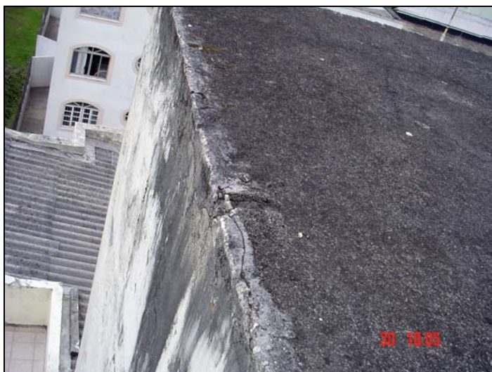
Figura 66 - Inexistência de escoamento definido e marcas de microorganismos na parede externa do reservatório superior
