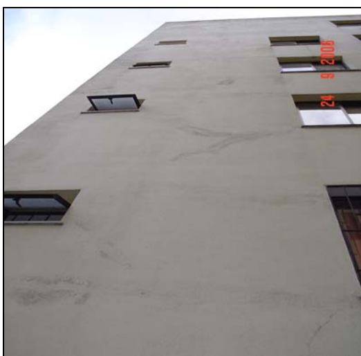
Figura 72 - Marcas das intervenções realizadas sobre as fissuras
