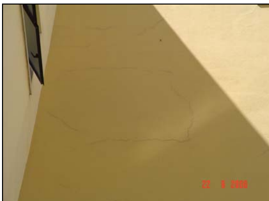
Figura 80 - Fissuras existentes junto a parede da escadaria situada junto à fachada noroeste.
