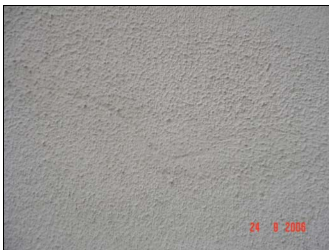
Figura 73 - Detalhe da marca da impermeabilização das fissuras realizada em 1999.
