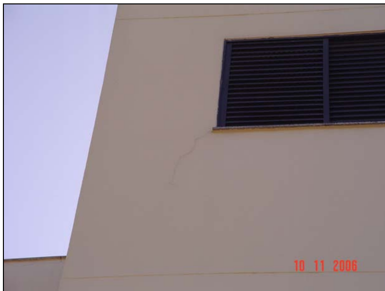
Figura 90 - Fissura com inclinação próxima de 45° no cantos inferior da janela
