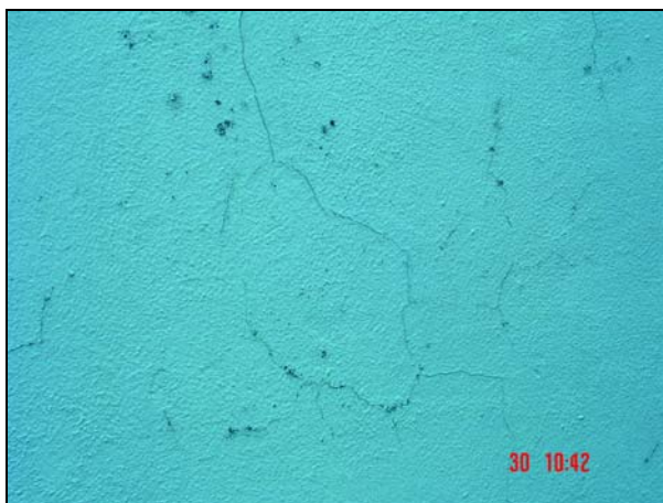
Figura 56 - Fissuras generalizadas em todo o reboco da fachada noroeste.
