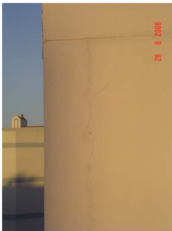
Figura 93 - Fissura na interface da alvenaria com pilar
