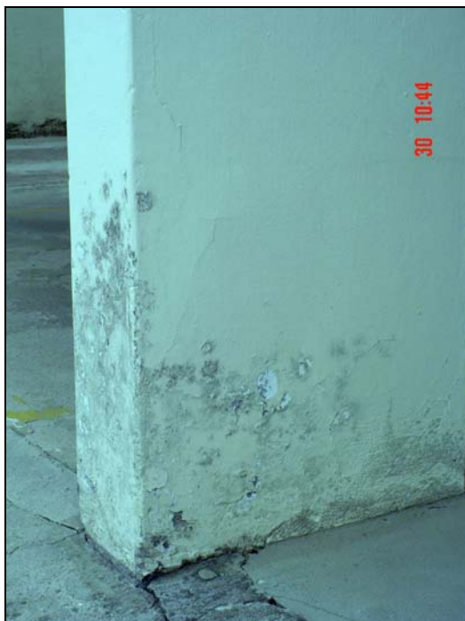
Figura 44 – Fissuras no RAF e manchas de bolor no pilar situado na garagem térrea
