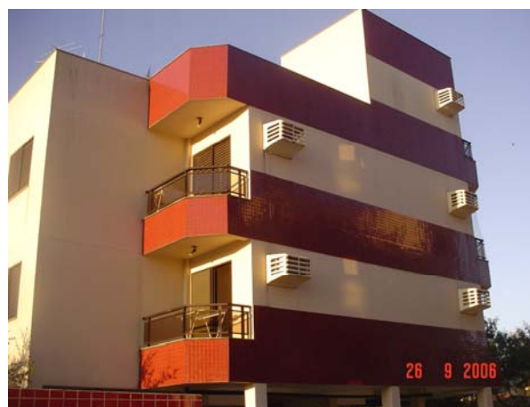
Figura 95 - Sujidades nas platibandas próximas às sacadas. Parede com orientação ao sul
