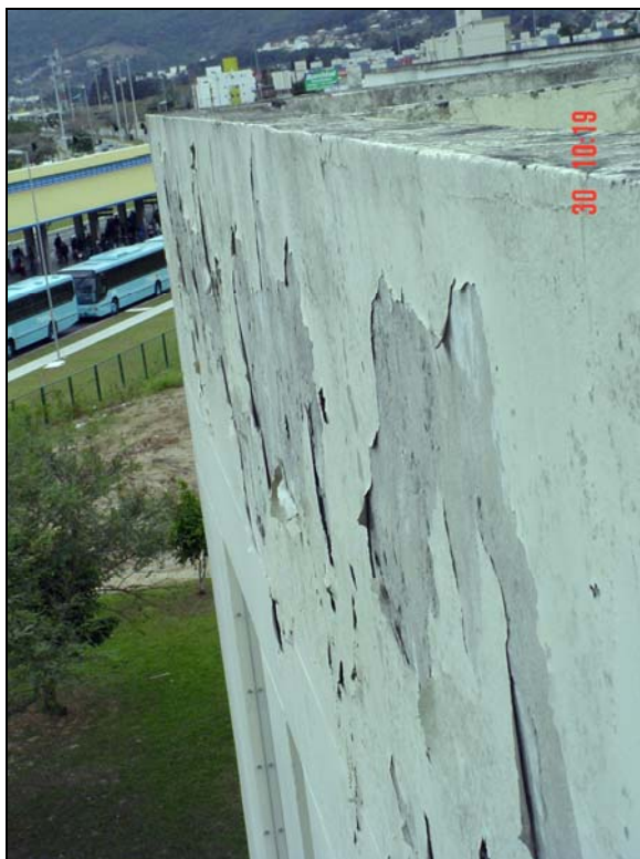
Figura 63 - Desagregamento do RAF e da tinta da região da platibanda junto a calha.
