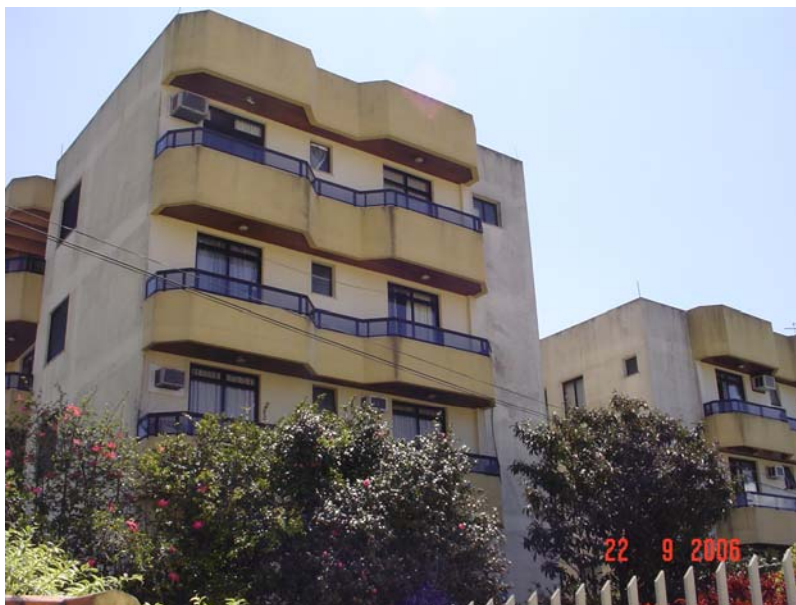
Figura 78 - Aspecto da fachada sudeste com as sacadas e paredes manchadas por sujidades e por microrganismos. É possível observar que as paredes protegidas pelas sacadas se encontram com menor intensidade de manchas.
