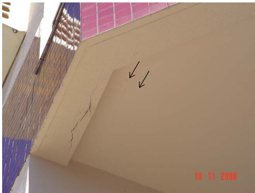
Figura 91 - Rachaduras no RAF decorrentes da corrosão das armaduras da viga e empolamento da pintura junto ao teto (indicado pelas setas).
