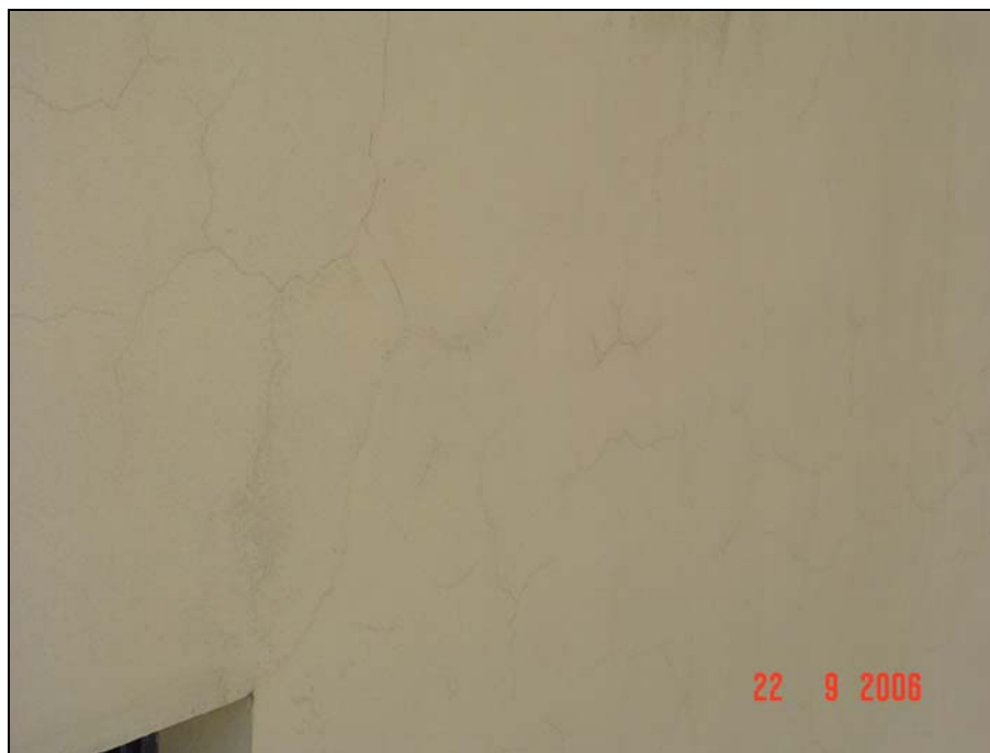
Figura 82 - Fissuramento do RAF nas paredes em torno do reservatório superior
