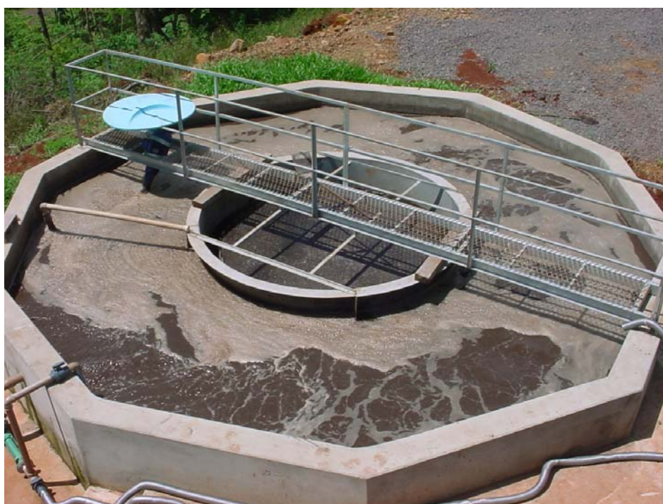
Figura 4.4: Vista superior do reator biológico aerado e ao centro o decantador secundário, fonte do inóculo para o Reator RBA.
