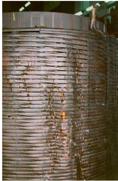
Figura 2.8: Deslocamento de bobinas em um enrolamento com afundamentos locais
