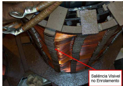
Figura 2.6: Encurvamento de um enrolamento devido a esforços mecânicos
