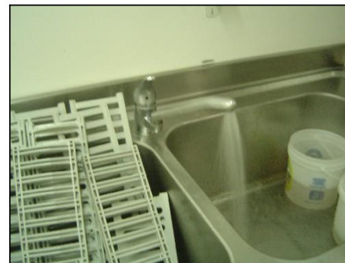
Foto – Torneira da cozinha do hotel sem arejadores. Consumo alto.
