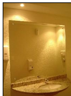
Foto – Iluminação dos banheiros das UH'S é feita com lâmpadas incandescentes e/ou dicróica.
