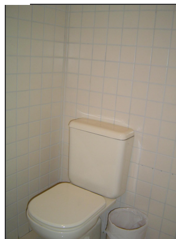
Foto – Uso de caixas acopladas 6 litros nos BWC das áreas sociais.
