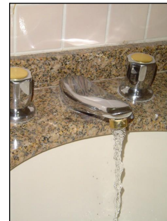
Foto – torneiras das UH'S com arejadores para economia de água.
