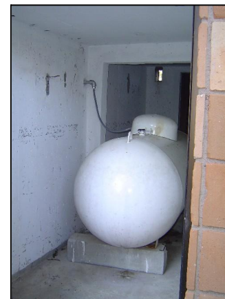
Foto – central de gás que fica na parte de trás do hotel – serve os banheiros das UH'S e demais serviços.
