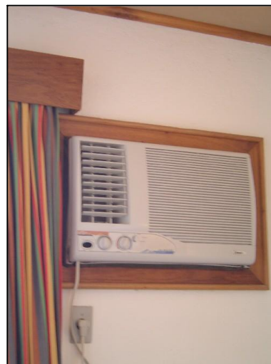
Foto – ar condicionados nas UH'S – todos sem o Selo Procel de eficiência energética.
