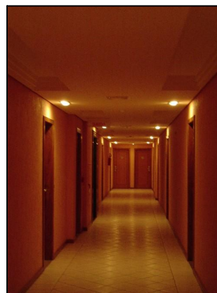
Foto – corredores das UH'S usa luz artificial e sensor de presença.
