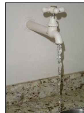
Foto – torneira da cozinha das UH'S sem arejadores. Consumo alto.
