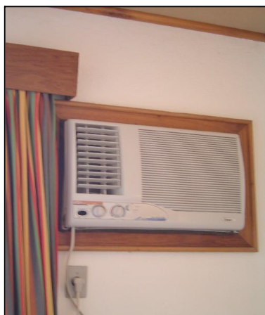
Foto 33: Ar condicionados nas UH'S – todos sem o Selo Procel de eficiência energética – Costa Norte Hotel
