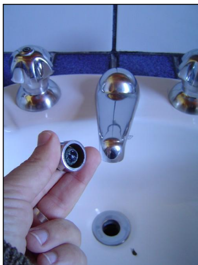
Foto – Detalhe do arejador que é colocado nas torneiras dos lavatórios das UH'S como forma de economia de água.
