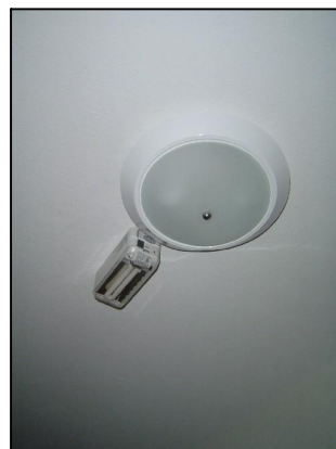
Foto – uso de sensor de presença nos corredores que dão acesso as UH'S.
