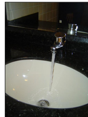
Foto – Uso de misturadores de fechamento automático nos BWC das áreas sociais.
