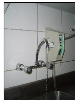
Foto – torneira da cozinha do hotel sem arejadores. Consumo alto.
