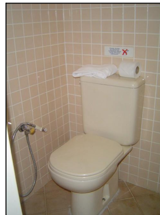
Foto – utilização de caixas acopladas 6 litros em todas as UH'S do empreendimento.
