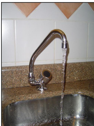
Foto – Torneira da pia das UH'S com arejadores.
