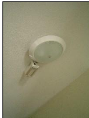
Foto - uso de sensor de presença nos corredores que dão acesso as
