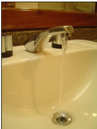
Foto – Torneira dos lavatórios das UH'S com arejadores
