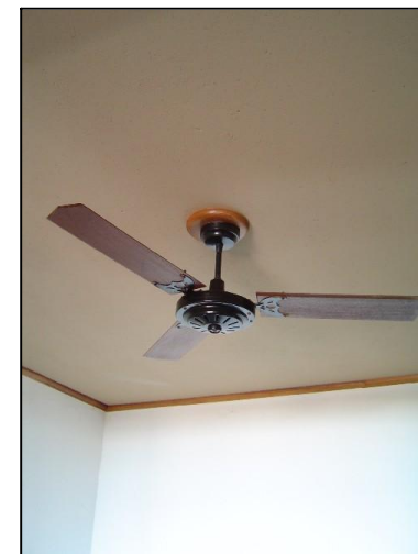
Foto 00 – Ventiladores de teto como parte da ventilação do hotel para não haver somente o uso do ar condicionado.
