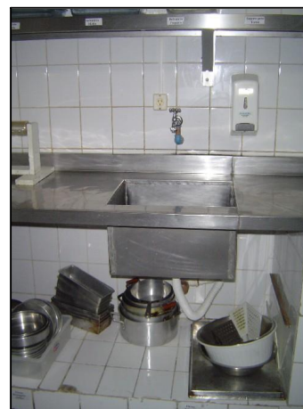
Foto – pia da cozinha do hotel sem nenhum tipo de arejador nas torneiras ou acionamento pelos pés.
