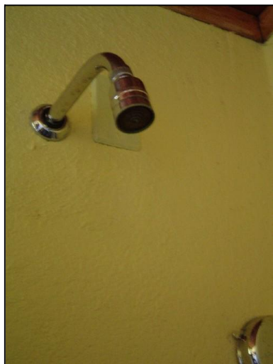
Foto – detalhe dos chuveiros que se encontram nas UH'S – sistema a gás e com arejadores.
