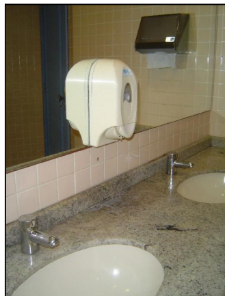
Foto – torneiras com fechamento automático da Linha Docol em banheiros sociais do hotel.
