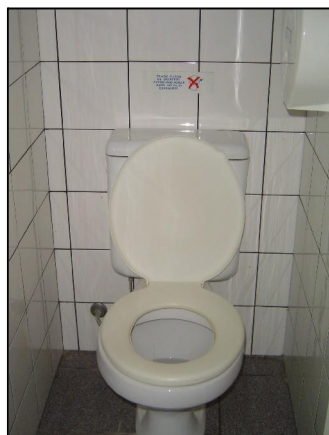
Foto – presença de caixas acopladas nos banheiros dos funcionários – parte de serviços.
