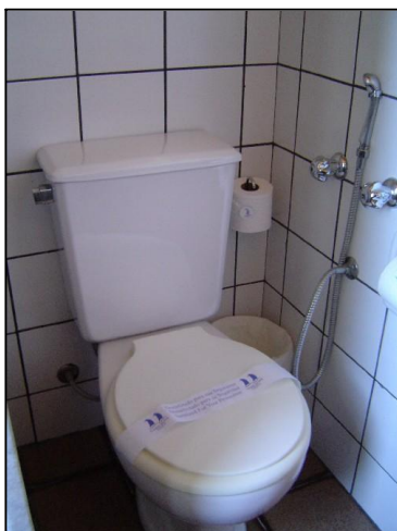
Foto – Detalhe das caixas acopladas 6 litros que se encontram todas as UH'S do hotel.
