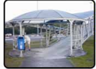
Foto 02 - Alongamento na passarela.
