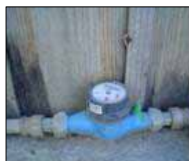
c) Hidrômetro instalado na alimentação do tanque de lavar roupa.
