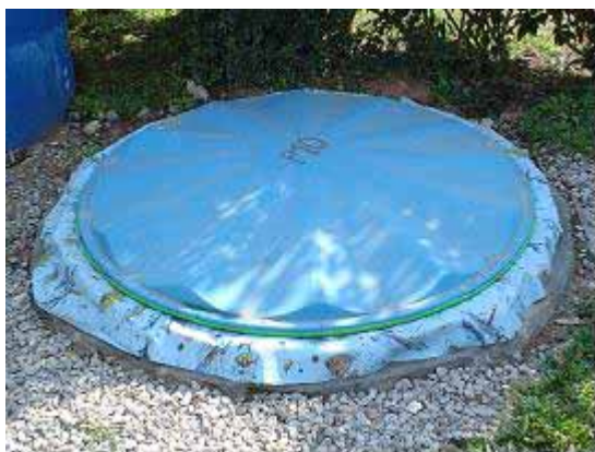
d) Cisterna de água de chuva
