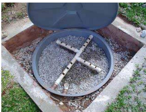
Figura 21: Filtro de brita para o tratamento da água cinza.
