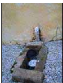
a) Hidrômetro instalado na alimentação da Pia de cozinha.
