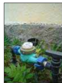
d) Hidrômetro instalado na alimentação geral da residência.
