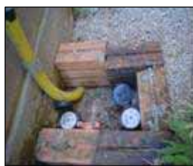
b) Hidrômetro instalado na alimentação do chuveiro e lavatório e da bacia sanitária.
