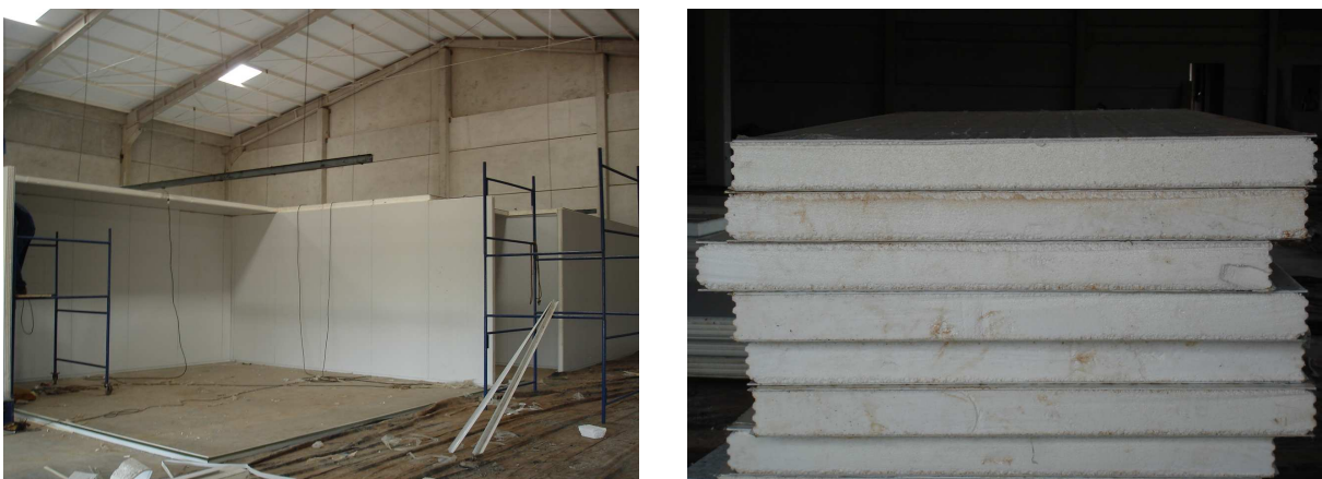
Figura 42 - Câmara fria com utilização de painéis isolantes pré-fabricados.
