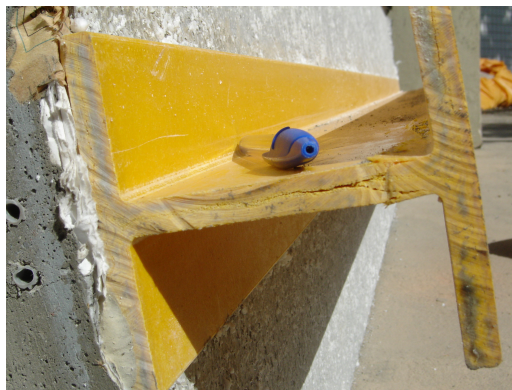
FIGURA 7.22 – Ruptura na alma dos perfis pultrudados na laje mista 02.
