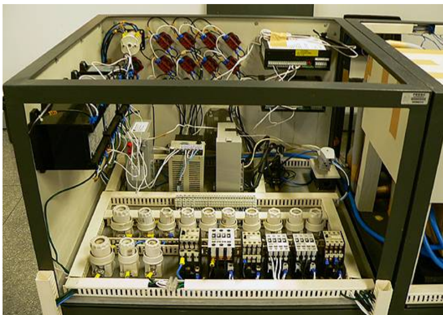
Figura III.2 - Plataforma dos componentes elétricos
