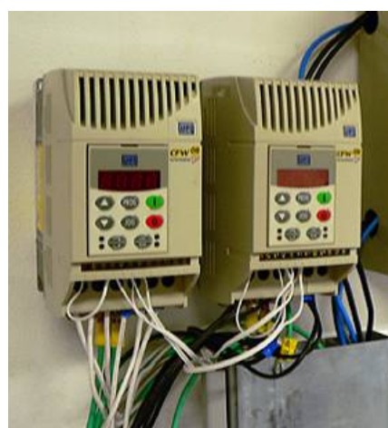
Figura III.5 - Inversores de frequência dos motores elétricos das bombas
