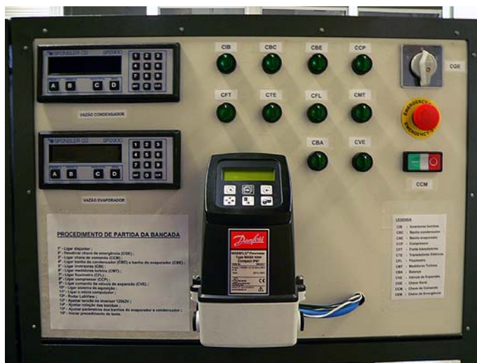
Figura III.3 - Painel de controle da bancada
