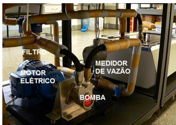
Figura 3.11 - Bomba de palhetas, filtro e medidor de vazão volumétrica (circuito do evaporador)
