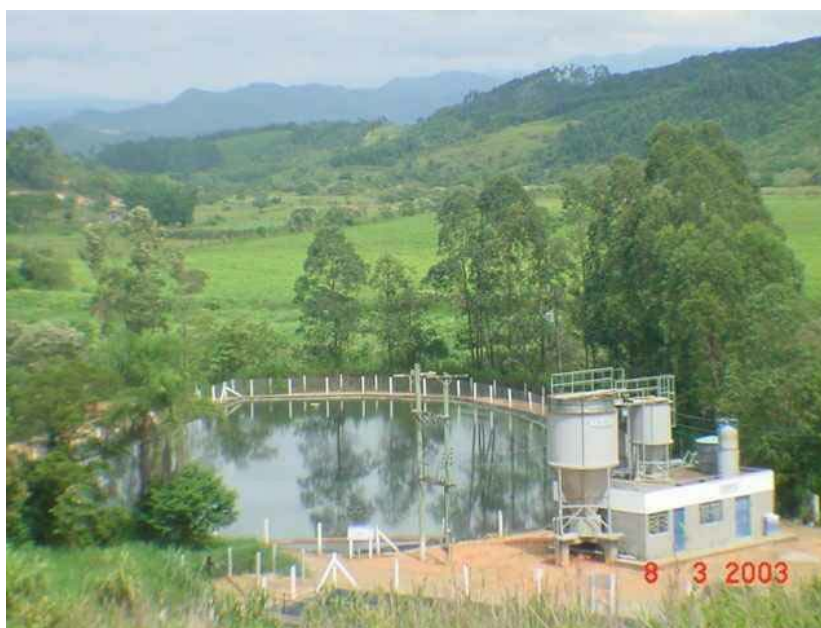
FIGURA 5: Reator UASB e laboratório de tratamento físico-químico do aterro sanitário de Biguaçu. Ao fundo o sistema de lagoas de tratamento.
