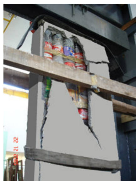
Figura 5.16 : ruptura da camada de 20mm de argamassa do painel.
