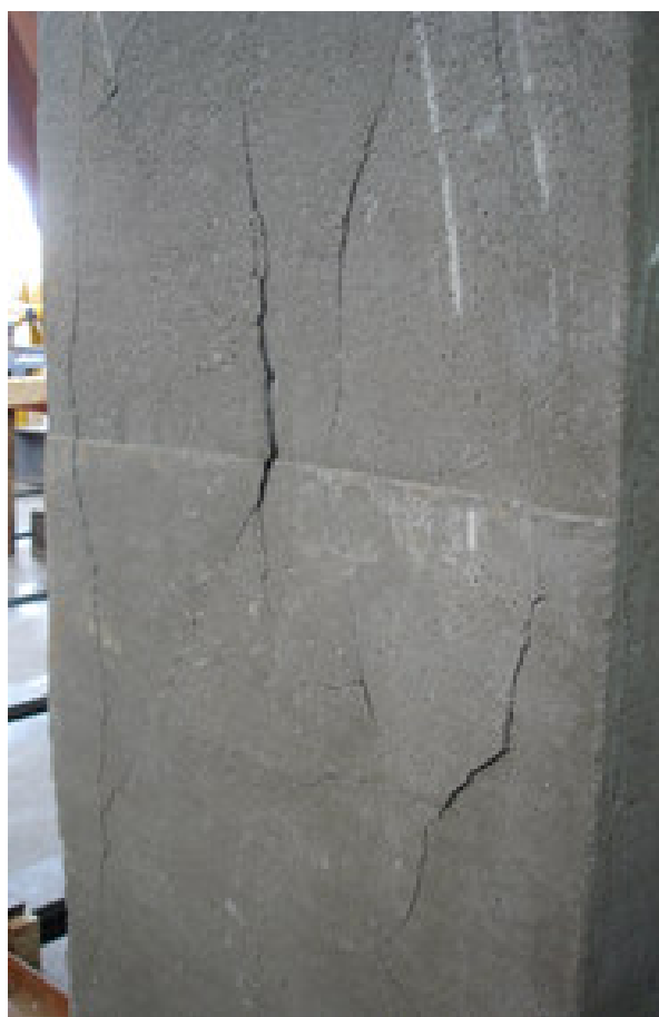
Figura 5.9 : ruína do painel devido à deformação excessiva.
