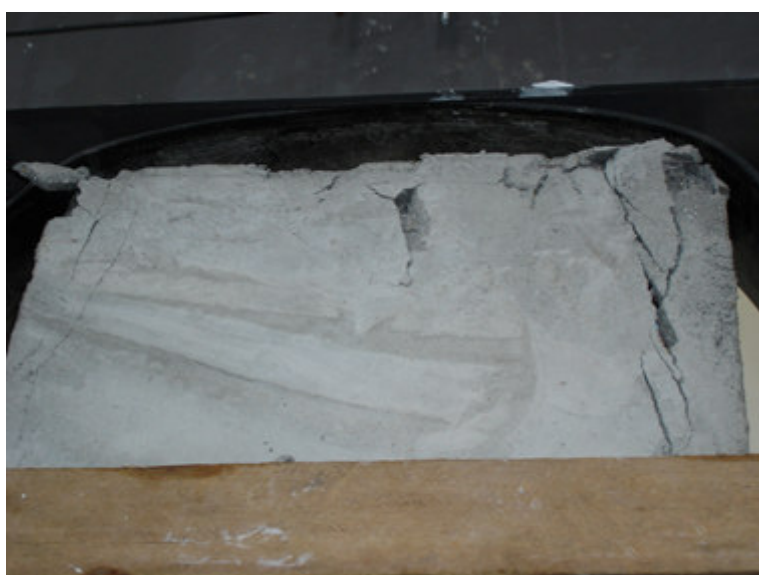
Figura 5.15 : fissuras graduais no painel.
