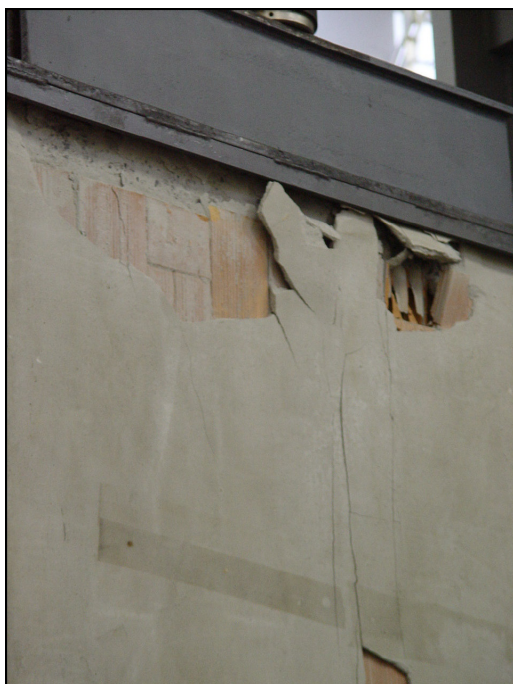
Figura 5.19 : Desprendimento do reboco na parte superior do painel 8. Fonte: Casas Industrializadas Dominó – Parte 2.
