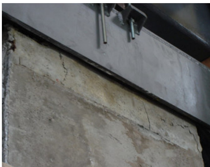
Figura 5.13 : início das fissuras no painel.
