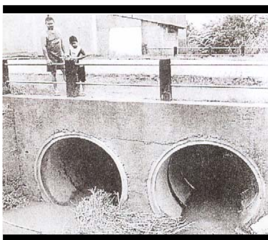
FOTO 14 – Tubos que geravam o afunilamento do ribeirão e obstruíam a passagem dos fluxos d'água mais intensos. (Jaraguá do Sul – SC, fev. de 2001).
