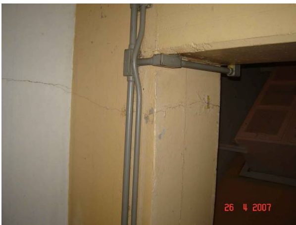
Figura 3.9 – Fissura encontrada na Casa de Força da UHE Passo Fundo.
