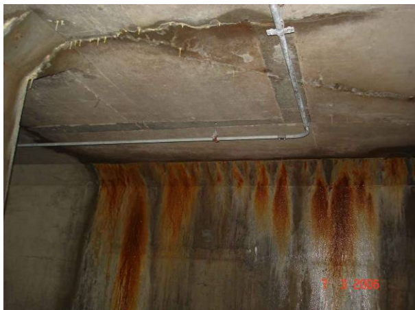
Figura 3.18 – Trinca encontrada no teto da galeria de drenagem do Vertedouro da UHE Machadinho.
