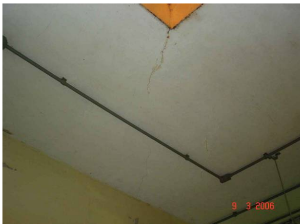
Figura 3.13 – Fissura à 45° encontrada na Casa de Força da UHE Passo Fundo.
