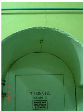
Figura 3.12 – Fissura encontrada na Casa de Força da UHE Passo Fundo.
