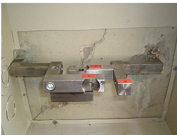
Figura 3.11 – Medidor triortogonal mecânico instalado para monitoramento da trinca na parede da Casa de Força da UHE Passo Fundo.
