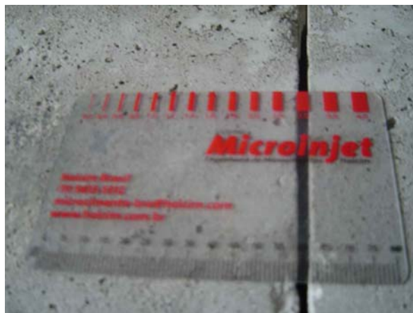
Figura 3.7 – Fissurômetro: Medida da abertura da fenda.
