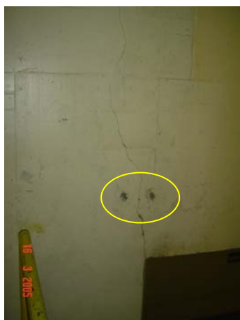
Figura 3.10 – Pino metálico para monitoramento da trinca na parede da Casa de Força da UHE Passo Fundo.
