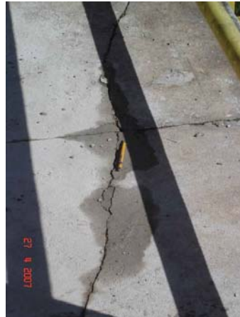
Figura 3.15 – Trinca encontrada no piso da Casa de Válvulas da UHE Passo Fundo.
