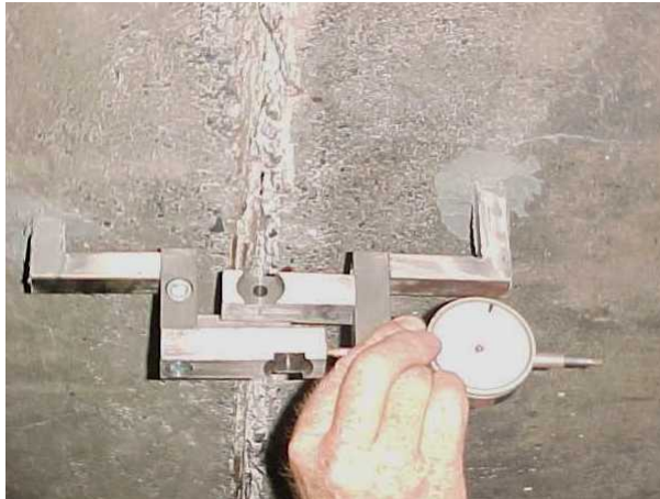
Figura 3.6 – Medidor triortogonal mecânico com realização das leituras.
