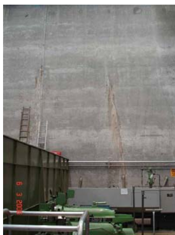
Figura 3.20 – Fissura com infiltração encontrada na Casa de Força da UHE Machadinho.
