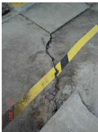
Figura 3.17 – Trinca encontrada na crista do Vertedouro da UHE Machadinho.
