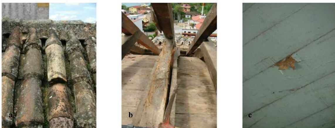
Ilustração 78 - a) detalhe da cobertura; b) estado de conservação de peças estruturais da cobertura; c) desprendimento de pintura do forro da nave. Fotos da autora 2006.
