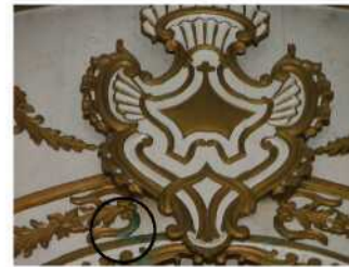
Oxidação da tinta metálica
