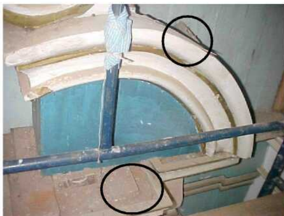
Ilustração 75 - Sujidade, depósito superficial de poeira e ataque de térmita. Foto da autora. 2004.
