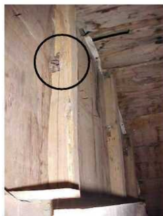
Ilustração - Perda de elemento estrutural
