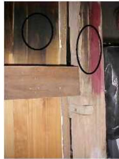
Mancha na estrutura e no entablamento
