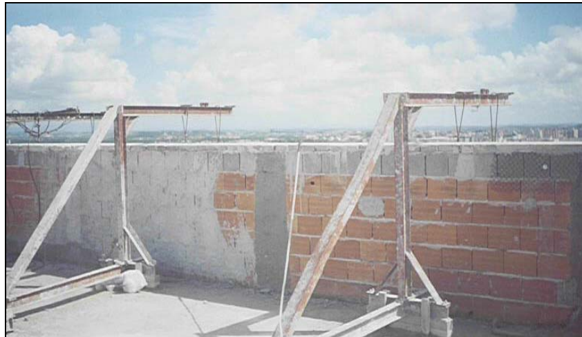
Ilustração 7.1: Estrutura do jaú afastada da platibanda.
