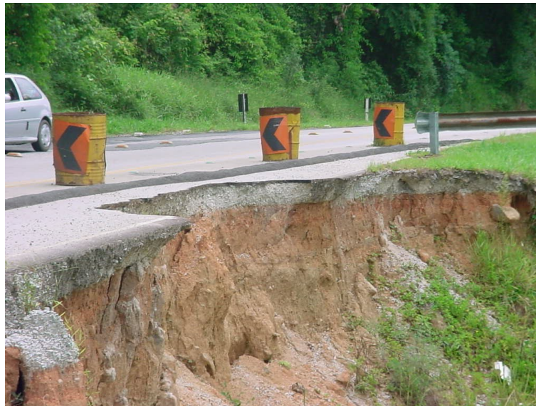
Figura 24 - Escorregamento no KM 33,1 da BR 282
