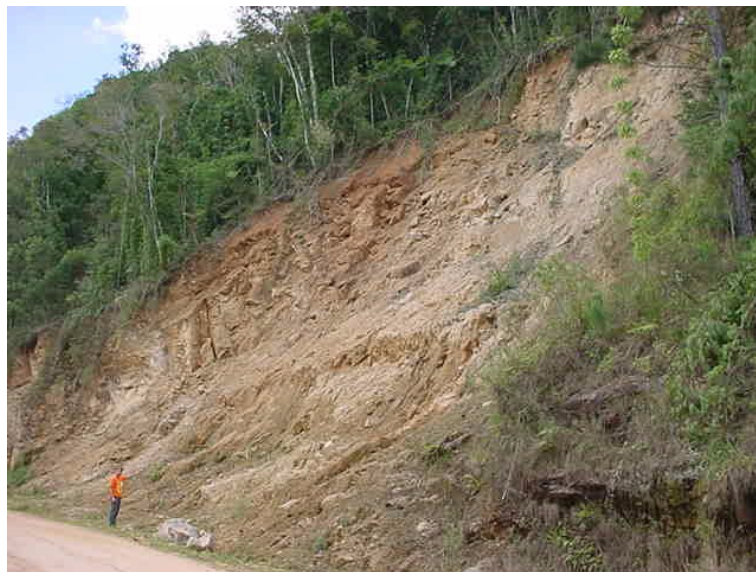
Figura 43 – Área de escorregamento no Granito Angelina
