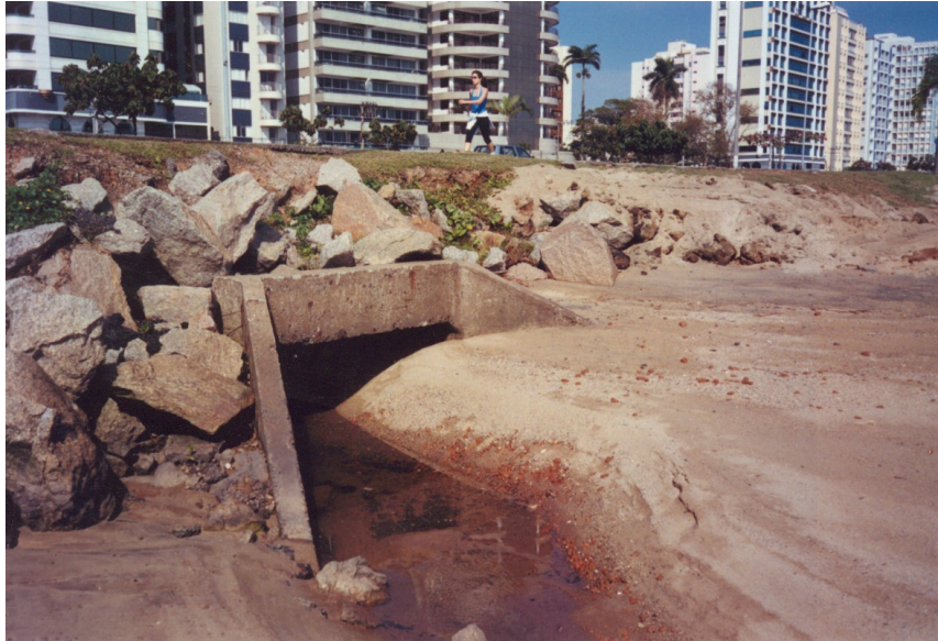
FIGURA 50: Esgoto sendo despejado nas águas da Baía Norte.
