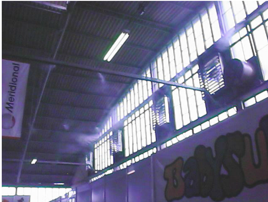
Figura 2.10 – Vista dos insufladores e do sistema de microaspersão, acionados por controlador.
