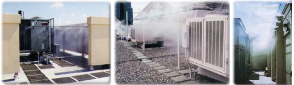
Figura 3.7 – Uso de microaspersão como pré-resfriamento da tomada de ar em sistema de condicionador de ar.
