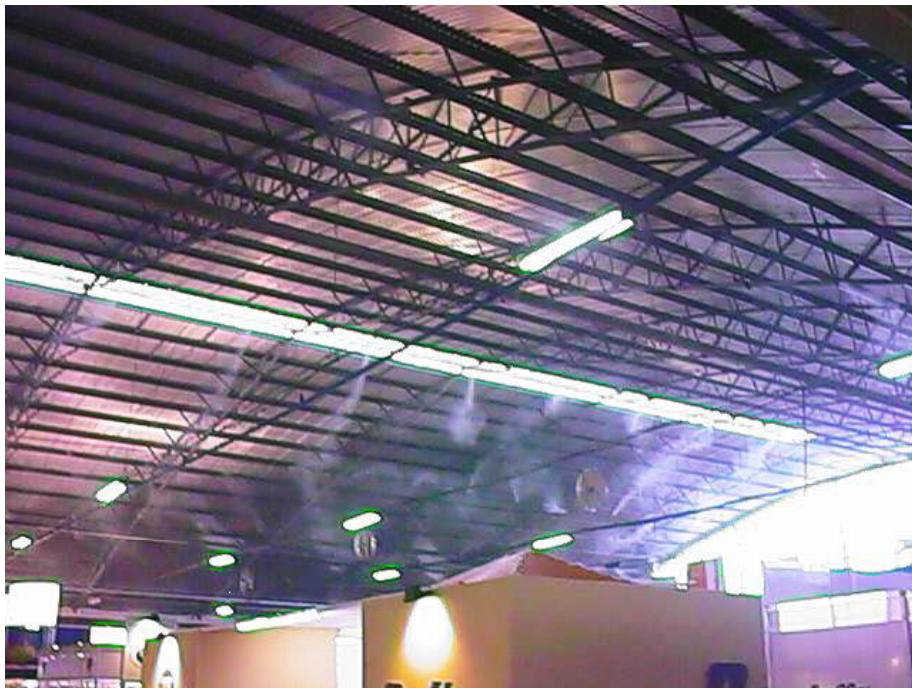
Figura 2.7 – Distribuição dos aspersores no interior de um ambiente – Novo Hamburgo - RS.
