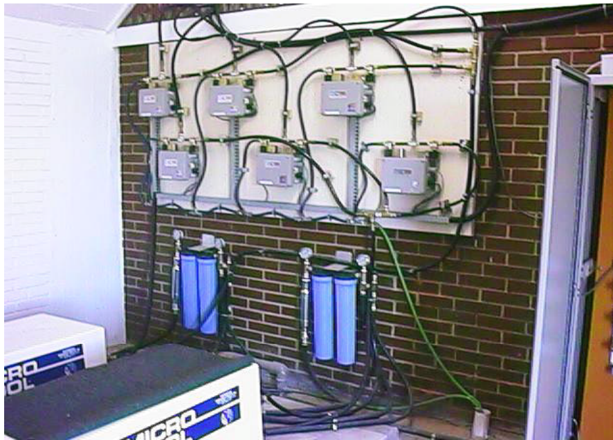
Figura 2.8 – Vista parcial do sistema de pressurização e filtragem em instalação de 12.000 m 2 .
