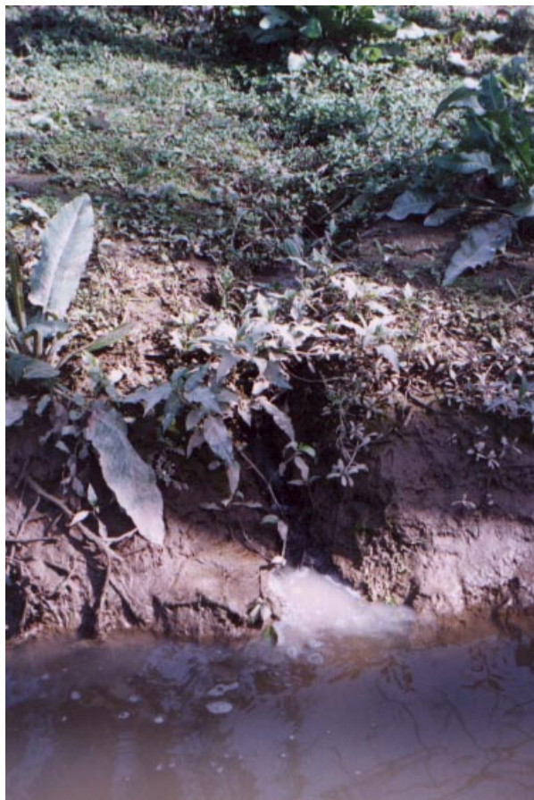
FIGURA 34: Saída de um cano que despeja no rio águas usadas de uma residência próxima, na área urbana do município.
