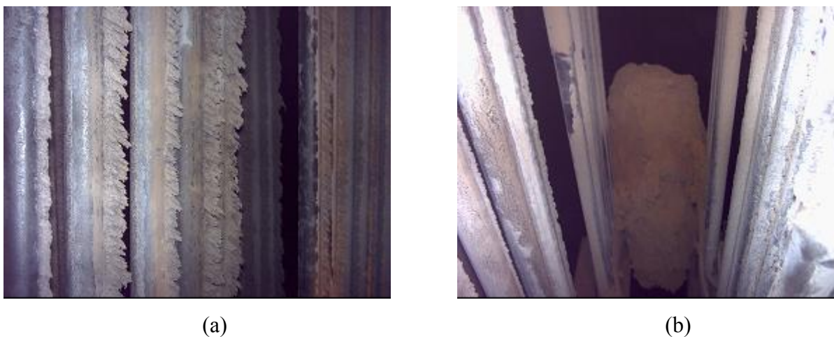
Figura 8 – Depósito de cinzas nos tubos do superaquecedor final
