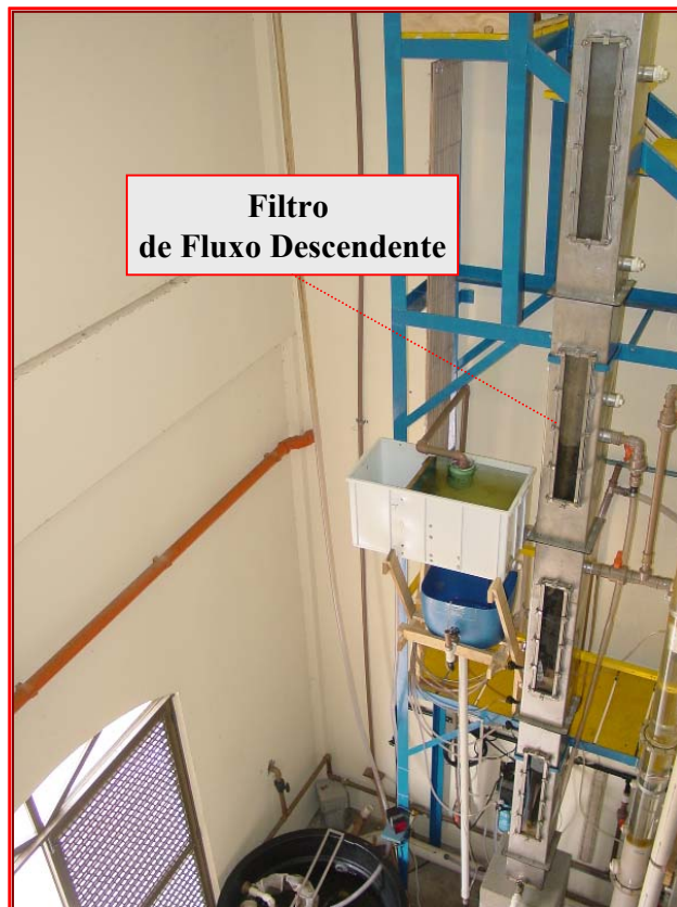
Figura 2.9 – Unidade de filtração direta descendente
