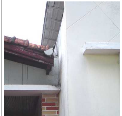
Aproximação B – Conflito no posicionamento da calha e demais elementos edificados.
