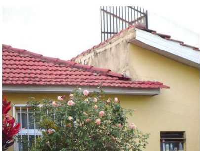
Aproximação C – Deságüe das águas sobre a parede gerando infiltrações.
