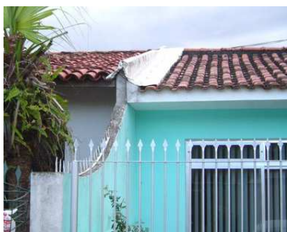
Aproximação E – Pequena diferença na inclinação gera a necessidade de acabamento em chapa de aço.
