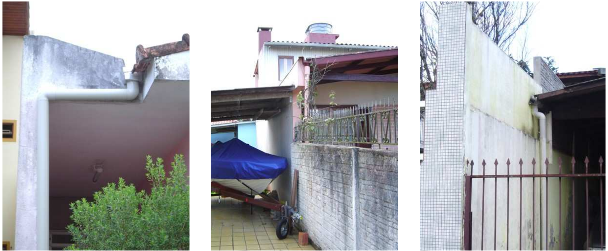
Figura 45 – Aproximação do caso de calhas e condutores no limite dos lotes. Balneário, Florianópolis-SC.
