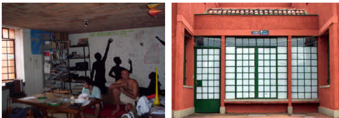
Ilustrações 4.36. e 4.37. Conforto térmico: pé-direito baixo e pequena espessura de parede
