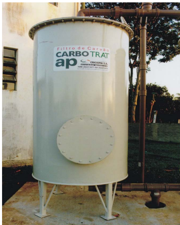
Figura 5 – Filtros de carvão CARBOTRAT AP instalados no município do Ermo / SC.
