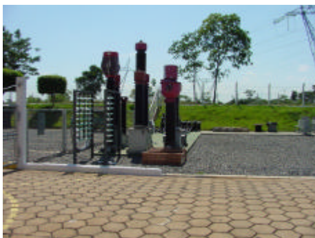
Figura 15 - Vista de fora da subestação antes da colocação dos sobressalentes. Fonte – SE Coxipó - MT.
