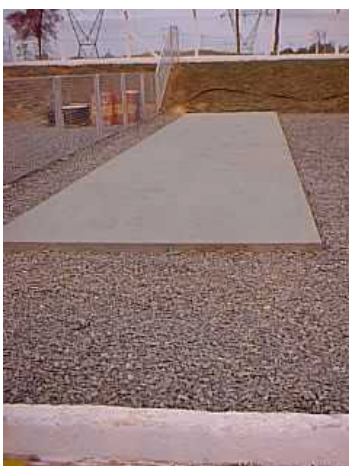
Figura 13 - Plataforma de concreto em fase de preparação para receber equipamento. – fonte SE – Coxipó - MT.
