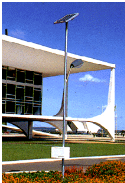
Fig. 1.16: Exemplo de poste alimentado com módulos fotovoltaicos
