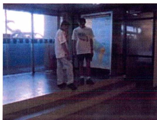
Figura 5.3 - Escada perigosa: sem qualquer sinalização.
