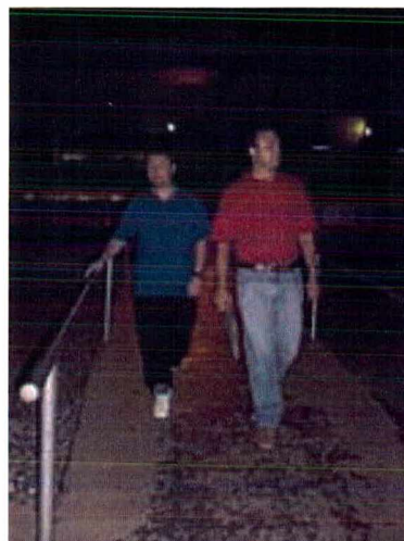
Figura 5.27 - Rampa de acesso para o estacionamento: corrimões e a própria rampa sem cores e ausência de iluminação.
