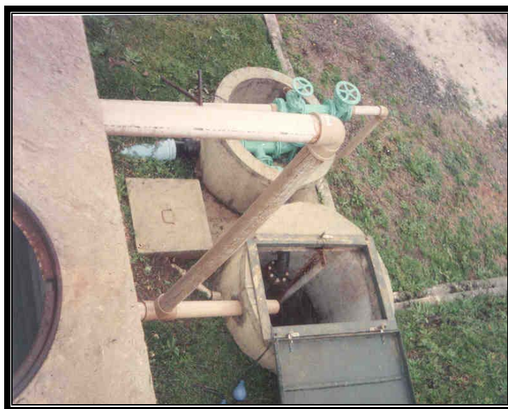
FIGURA 25 - POÇO DE ALIMENTAÇÃO DE LODO DE ESGOTO DA ETE GUARAITUBA
