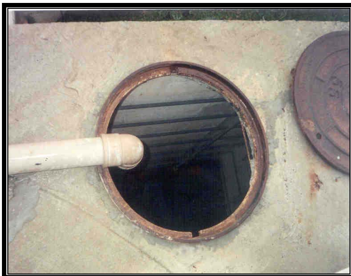
FIGURA 24 - TUBULAÇÃO DE DESCARGA DO LODO DE ESGOTO DO RALF NO TERMOHIDROLISADOR
