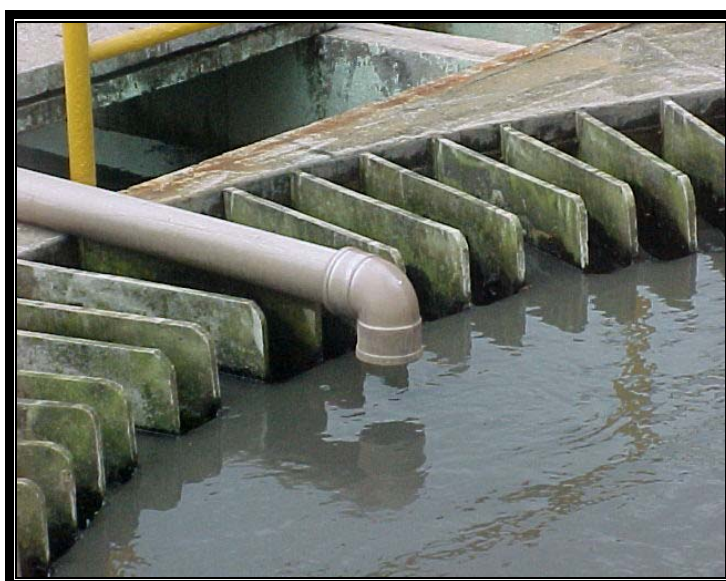
FIGURA 23 - TUBULAÇÃO PARA O RETORNO DO LODO TERMOHIDROLISADO AO RALF
