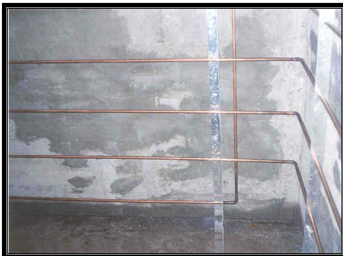
FIGURA 12 - TUBULAÇÃO INTERNA DE COBRE PARA A PASSAGEM DE ÓLEO AQUECIDO
