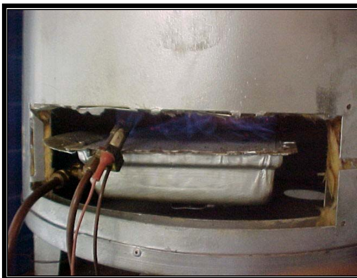
FIGURA 15 - QUEIMA DE BIOGÁS DENTRO DAS CALDEIRAS
