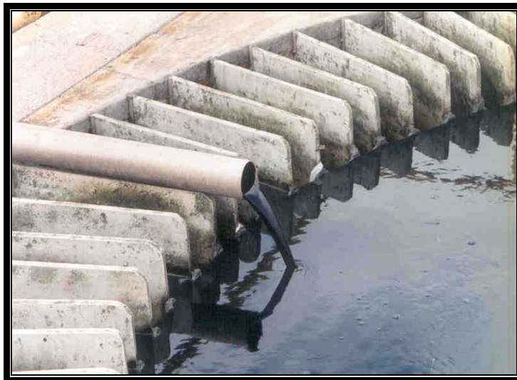
FIGURA 53 – RETORNO DO LODO TERMOHIDROLISADO NO PONTO DE DISTRIBUIÇÃO DO ESGOTO NO RALF.
