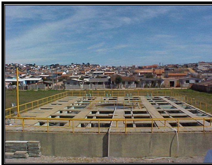
FIGURA 9 - VISTA GERAL DO RALF LOCALIZADO NA ETE DE GUARAITUBA EM COLOMBO
