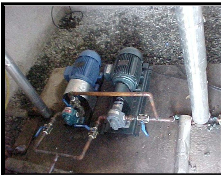
FIGURA 16 - BOMBAS PARA CIRCULAÇÃO DE ÓLEO AQUECIDO PELO SISTEMA
