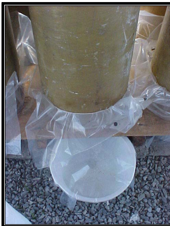
FIGURA 22 – BACIAS COLETORAS DE PERCOLADO
