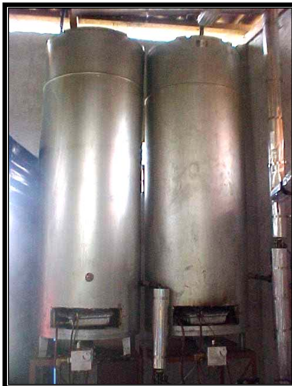
FIGURA 14 - CALDEIRAS DE AQUECIMENTO DE ÓLEO TÉRMICO COM A UTILIZAÇÃO DE BIOGÁS
