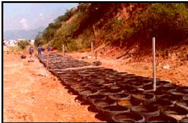
FIGURA 2.6 – Estágio inicial da construção do muro: posicionamento da 1ª camada de pneus. (FONTE: MEDEIROS et al., 1997)
