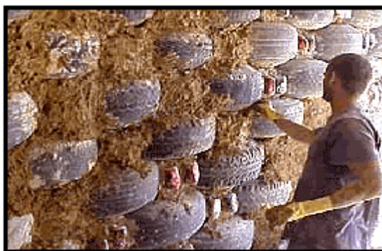
FIGURA 2.25 – Parede de pneus preenchida com barro e latas de alumínio. (FONTE: www.earthship.org )
