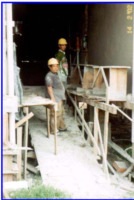
FIGURA 5.23: Execução do reboco no hall de entrada do bloco sem a necessidade de desmanchar os corrimãos de acesso aos blocos
