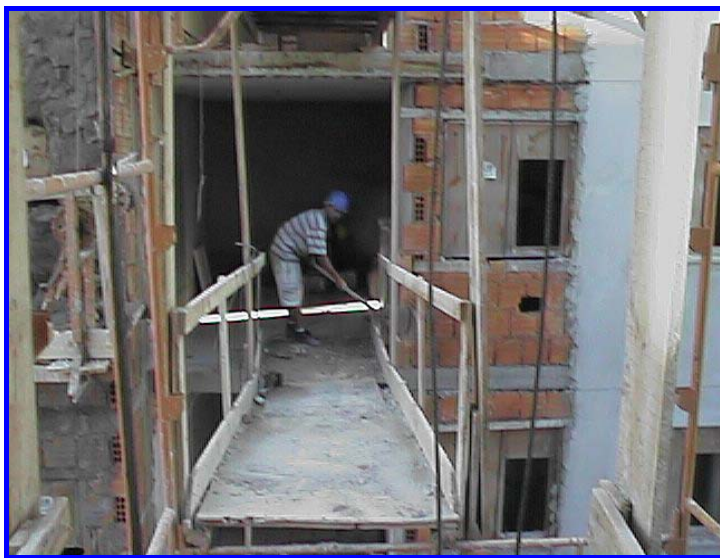
FIGURA 6.21: Limpeza na passarela entre os blocos “I” e o “H”, ocorrendo acúmulo de entulho ao redor dos blocos
