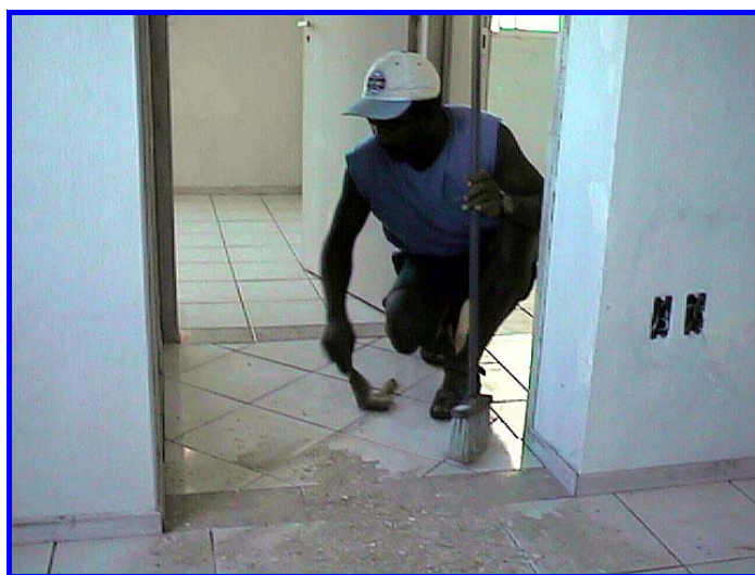
FIGURA 5.27: Retrabalho gerado pela demora para rejuntar o piso do bloco “A”
