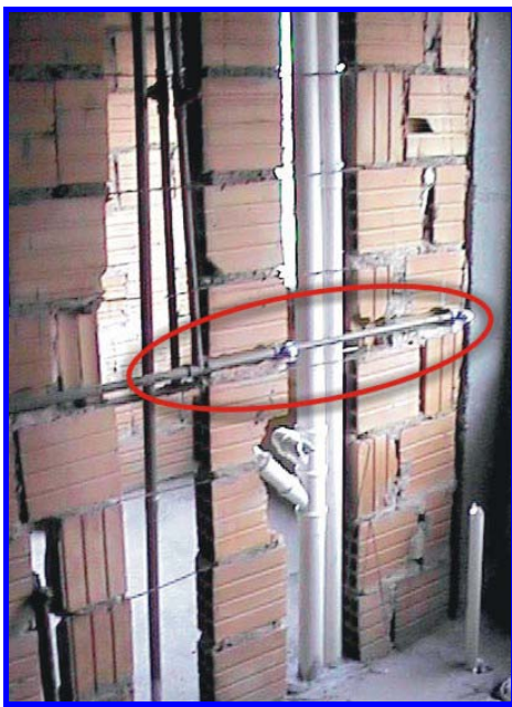
FIGURA 5.15: Tubulação hidráulica da cozinha
