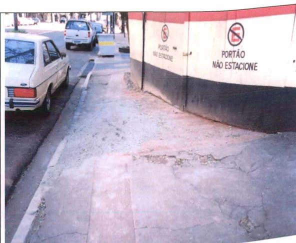
Figura 11: Tapume e falta de manutenção do calçamento
