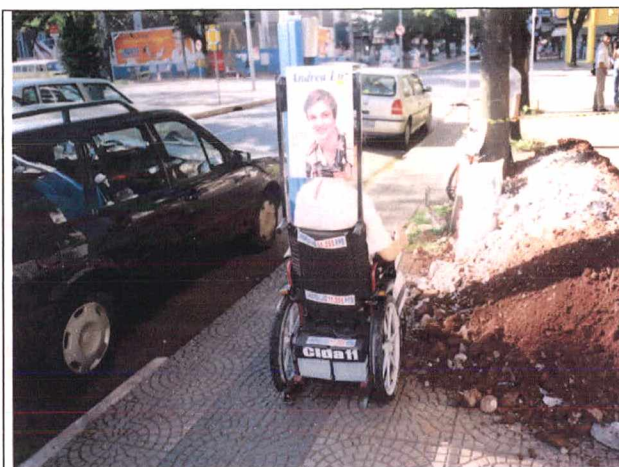
Figura 10: Obra não protegida ou sinalizada no passeio
