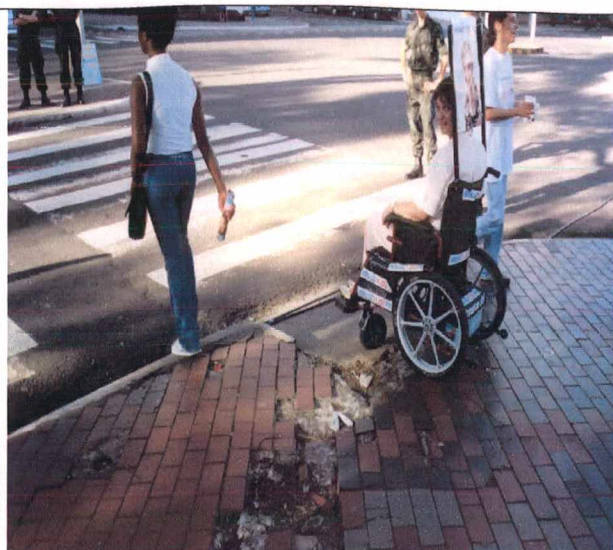
Figura 51: Falta de conservação do piso e do rebaixo de guia, dificulta a travessia.
