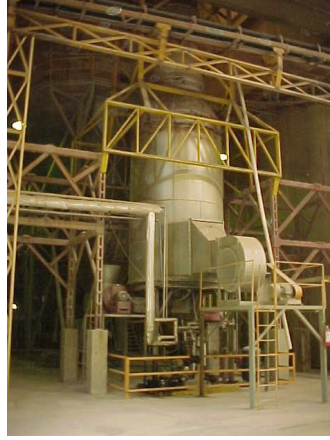
Figura 2. Foto da fornalha do sistema de atomização existente.
