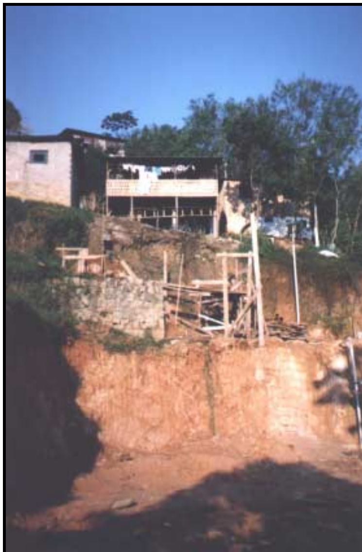
Figura 26 - Destaque para os cortes de terra feitos para expansão urbana nas encostas do Morro do Quilombo, auxiliando na instabilidade do terreno, bairro Itacorubi (outubro/2001).
