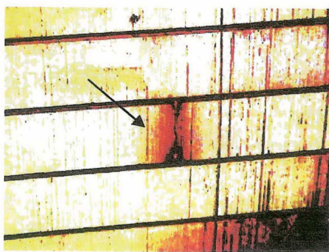
Fig.3.2. Vista ampliada de uma região do rotor afetada.
