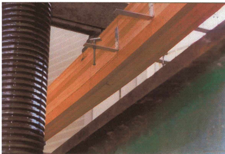
Figura 40 - Ruptura de uma das lâminas verticais
