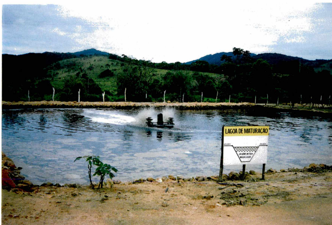
FOTO 2 - O chorume proveniente da decomposição dos resíduos é tratado antes de ser lançado em corpo d'água próximo.
