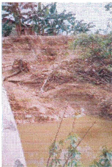
Foto 3.6 - Erosão da margem do igarapé devido à ocupação no bairro Conquista Foto: SEMEIA
