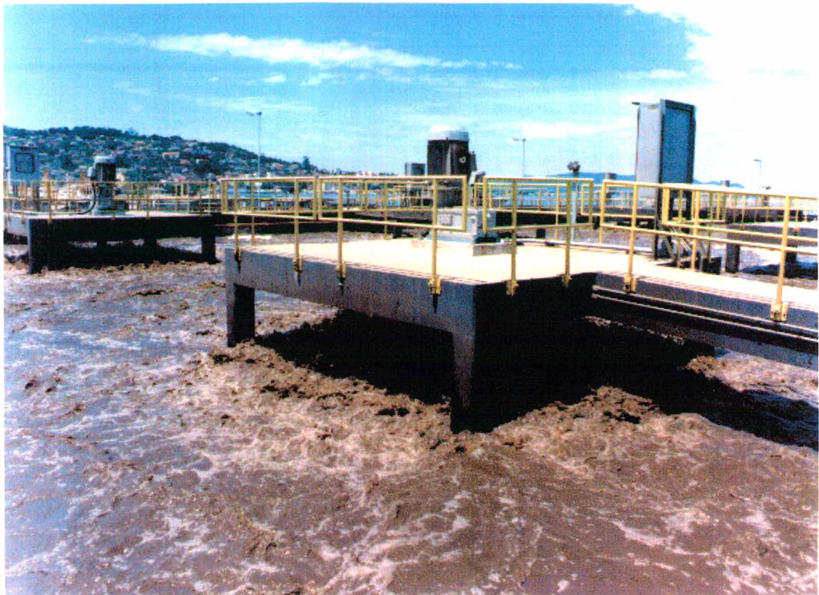
Figura 13 – Aerador mecânico de eixo vertical no tanque de aeração.
