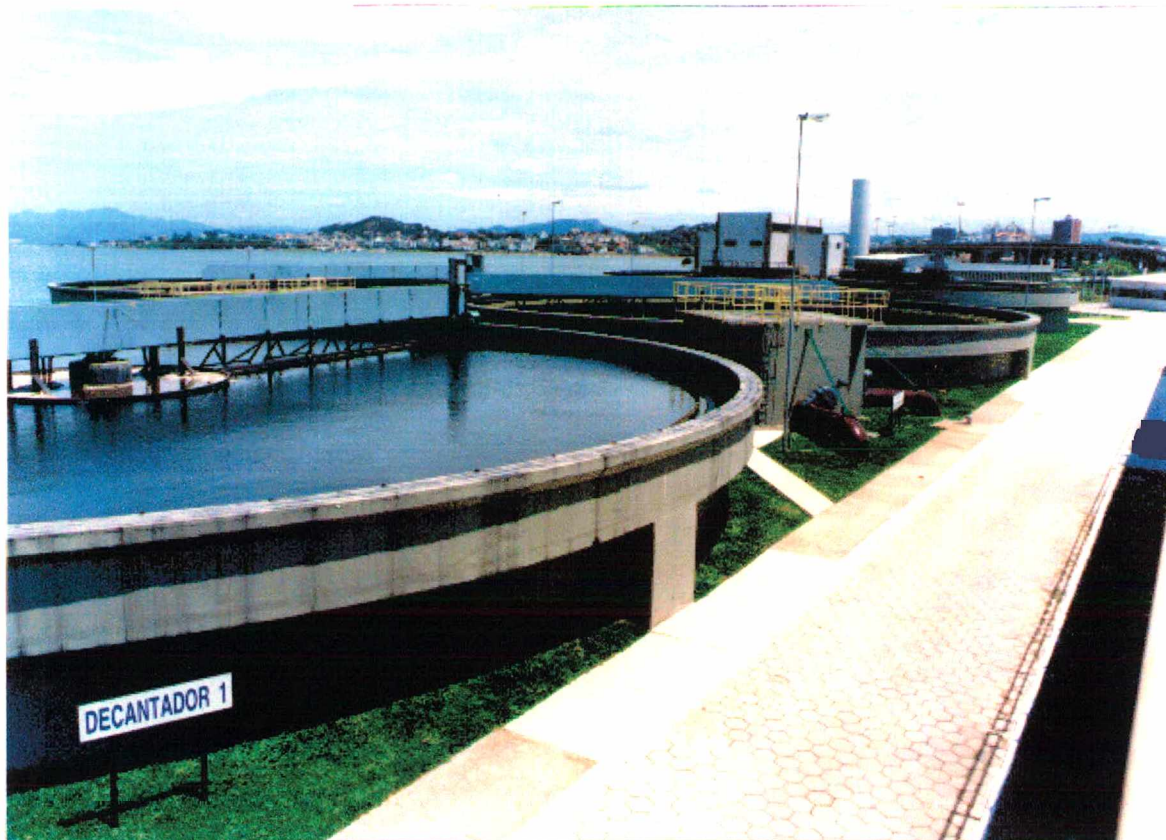
Figura 14 - Vista parcial do decantador secundário 1.
