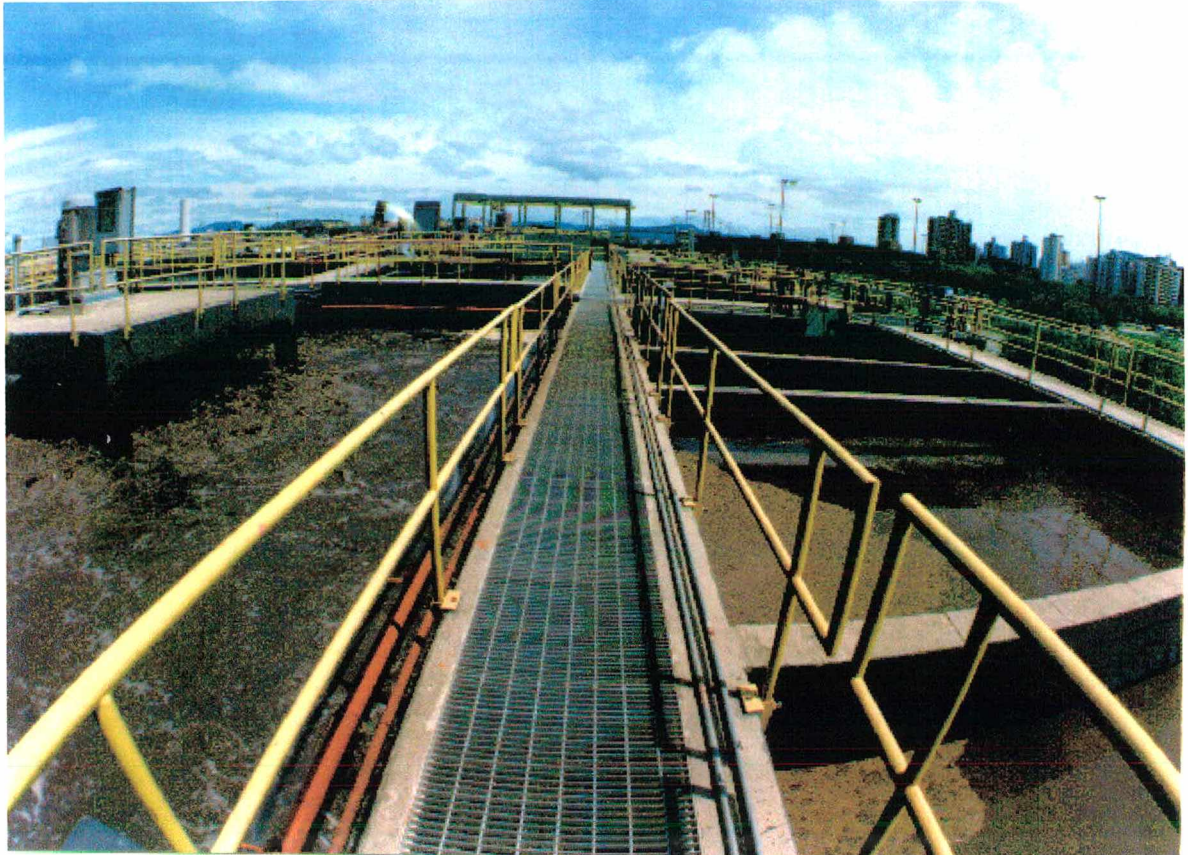
Figura 12 – Seletor biológico (lado direito) e parte do tanque de aeração (lado esquerdo).
