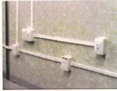
Canaletas Plástica para cabeamento elétrico e lógico
