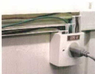
Exemplo de canaleta externa para passagem da fiação elétrica
