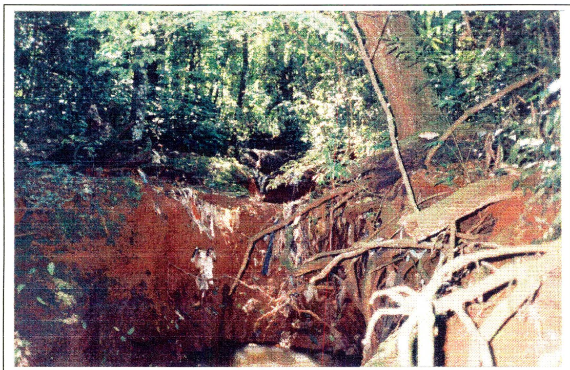
Foto 2: Área do Bosque II onde vêm-se os degraus mais altos resultantes de processo erosivo em degraus, como efeito das águas pluviais canalizadas e despejadas neste parque. Observam-se as raízes expostas das árvores e a concentração de resíduos sólidos transportados pelas águas. Data: abril de 1998. Foto da autora.
