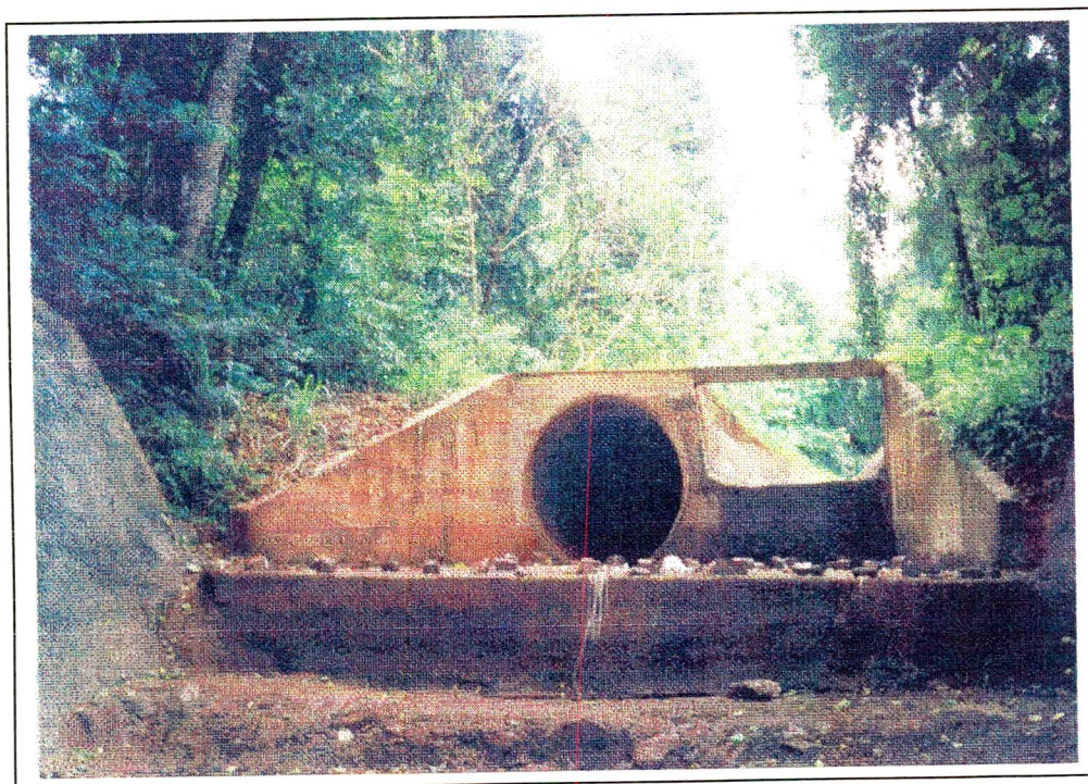
FOTO 6: "Tunnel Liner" a esquerda e a canalização aberta na margem direita do Córrego Moscados na área de incisão erosiva. Data: abril/98. Foto da autora.
