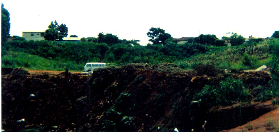
Voçoroca próxima a área residencial, onde regularmente é despejada grande quantidade de terra e entulhos - 1994.
