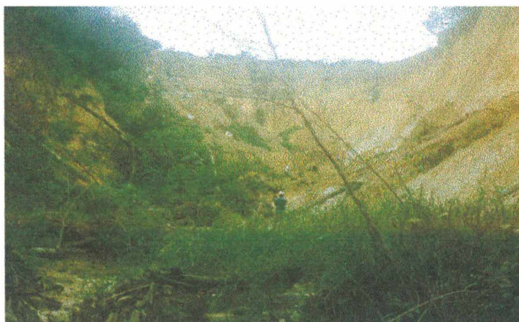
Foto 18 – Voçoroca Canaranas 1 antes da realização das obras de contenção. Manaus – AM. Janeiro/1995. (Foto do autor).
