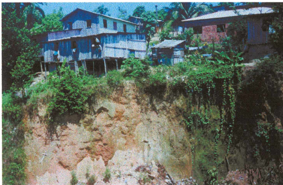
Vista parcial da Voçoroca Mauzinho 4. Jul./1995. Manaus (AM). (Foto do autor).
