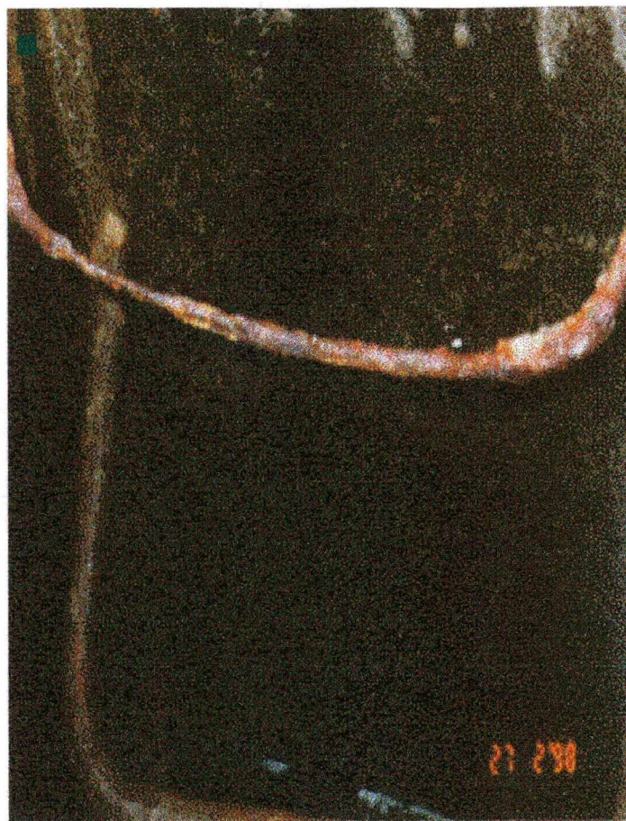
Figura 1.1 – Exemplo de corrosão causada pela presença do cloro.
