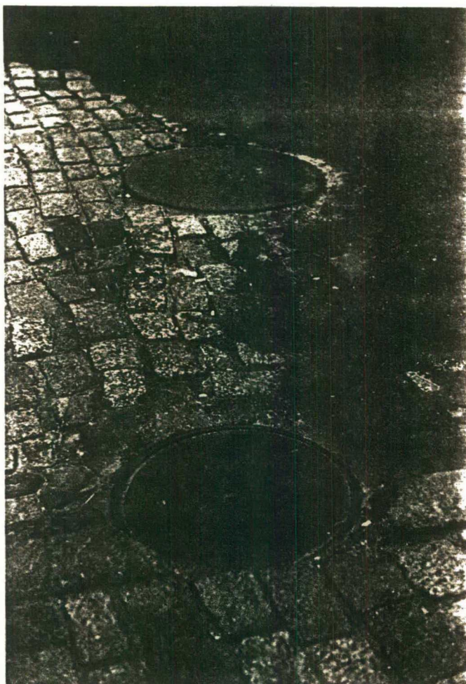
- Tampões de ferro fundido instalado no ano de 1913 sobre PVs localizados na Praça XV de Novembro - próximos à farmácia Vitória (gastos pela tráfego de veículos). Florianópolis - 1913.
