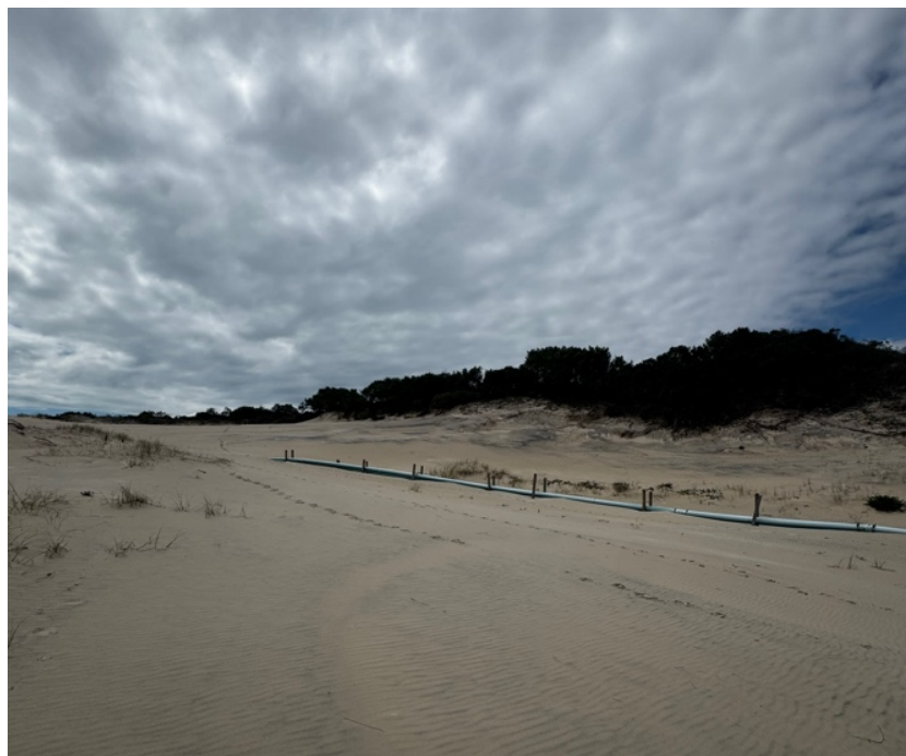
Figura 5 – Sistema de bombeamento emergencial de efluente tratado, instalado pela CASAN nas dunas
