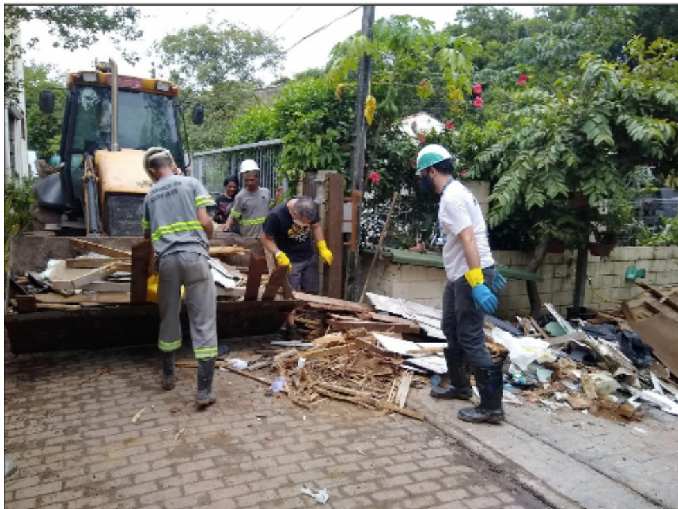
Figura 4 – Funcionários retirando da Servidão os objetos e escombros carregados pela água
