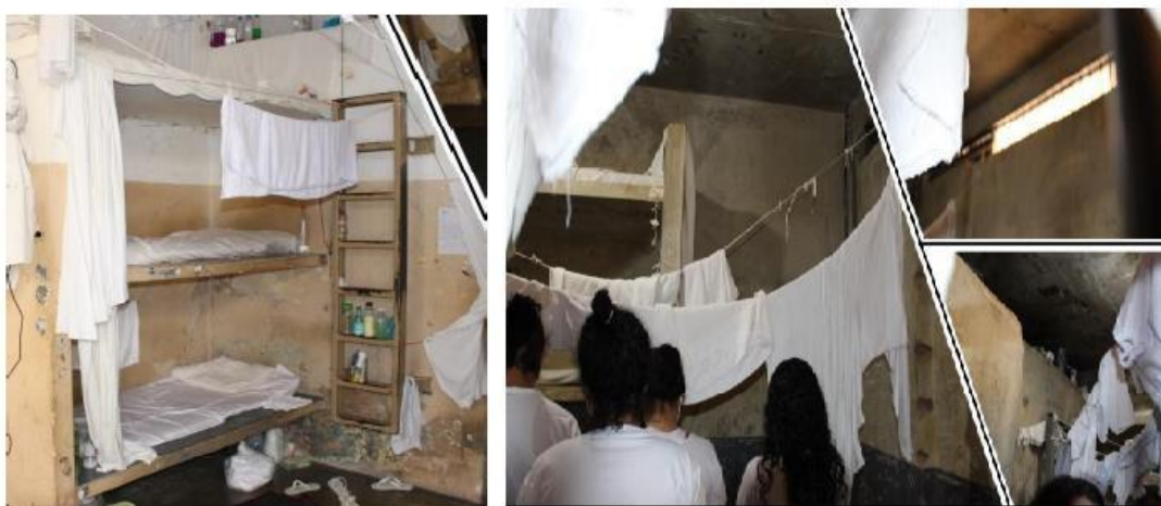
Figura 4: Celas deterioradas com pouca ventilação e iluminação natural da Unidade Regional Prisional Feminina de Luziânia em Goiás 2020
