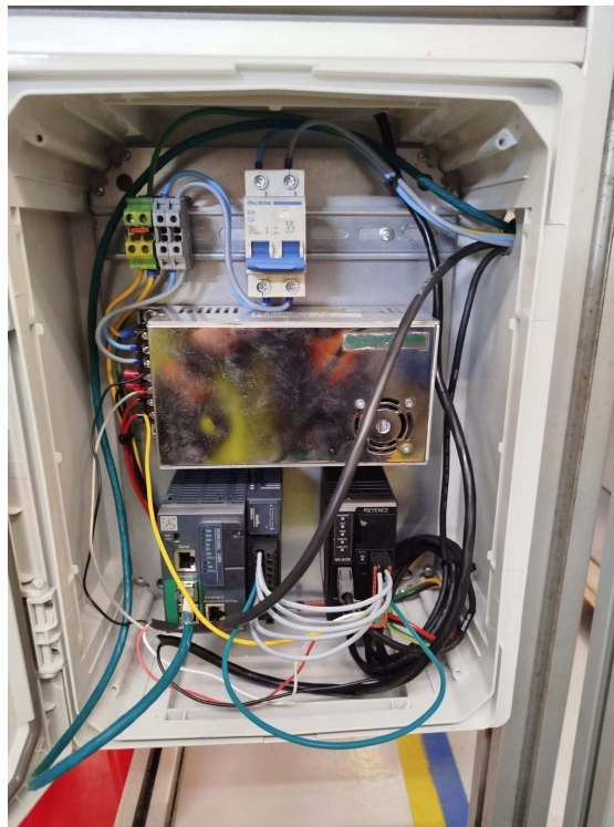
Figura 24 – Painel de controle do sistema de visão computacional.
