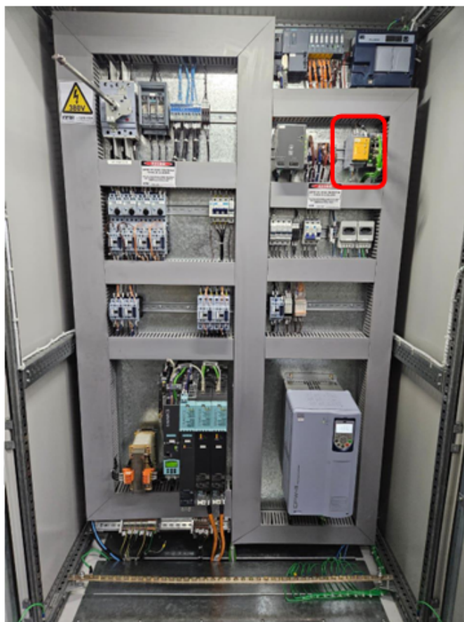
Figura 29 – Painel elétrico principal.
