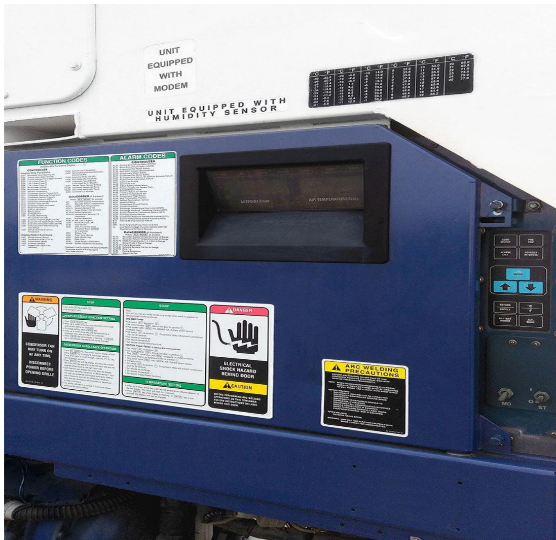
Figura 7 - Visor de informações de contêiner refrigerado.
