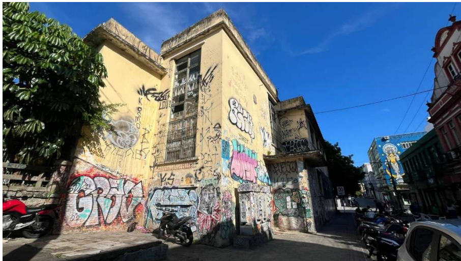
Figura 18: Estado atual do edifício localizado na Rua Saldanha Marinho, 156
